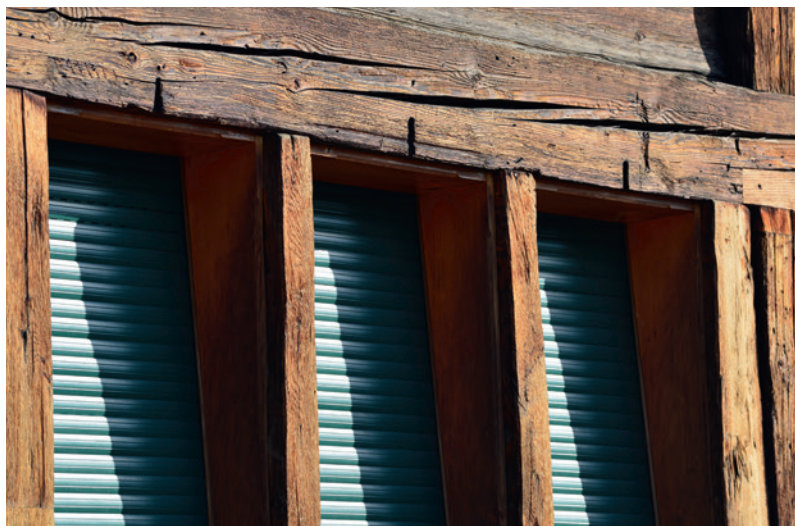
Vierteiliges Reihenfenster. Die ehemaligen Fallläden wurden mit einer durch die Schlitz über den Fenstern geführten Schnur von der Stube aus bedient.
