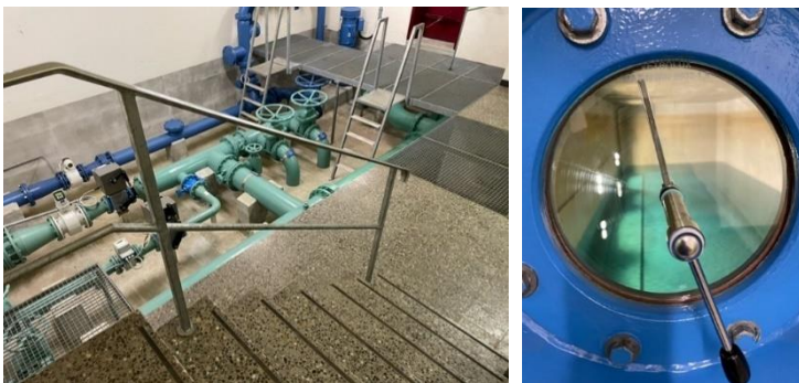
Die verschiedenen Rohre leiten das Wasser ins Reservoir und anschliessend weiter ins Trinkwassernetz von Kilchberg (Bild links). Durch ein kleines Fenster sieht man das Innere eines Wasserbehälters.
